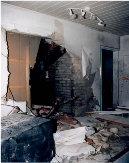
Abb. 49 Der eingemauerte Kamin nach der Explosion
